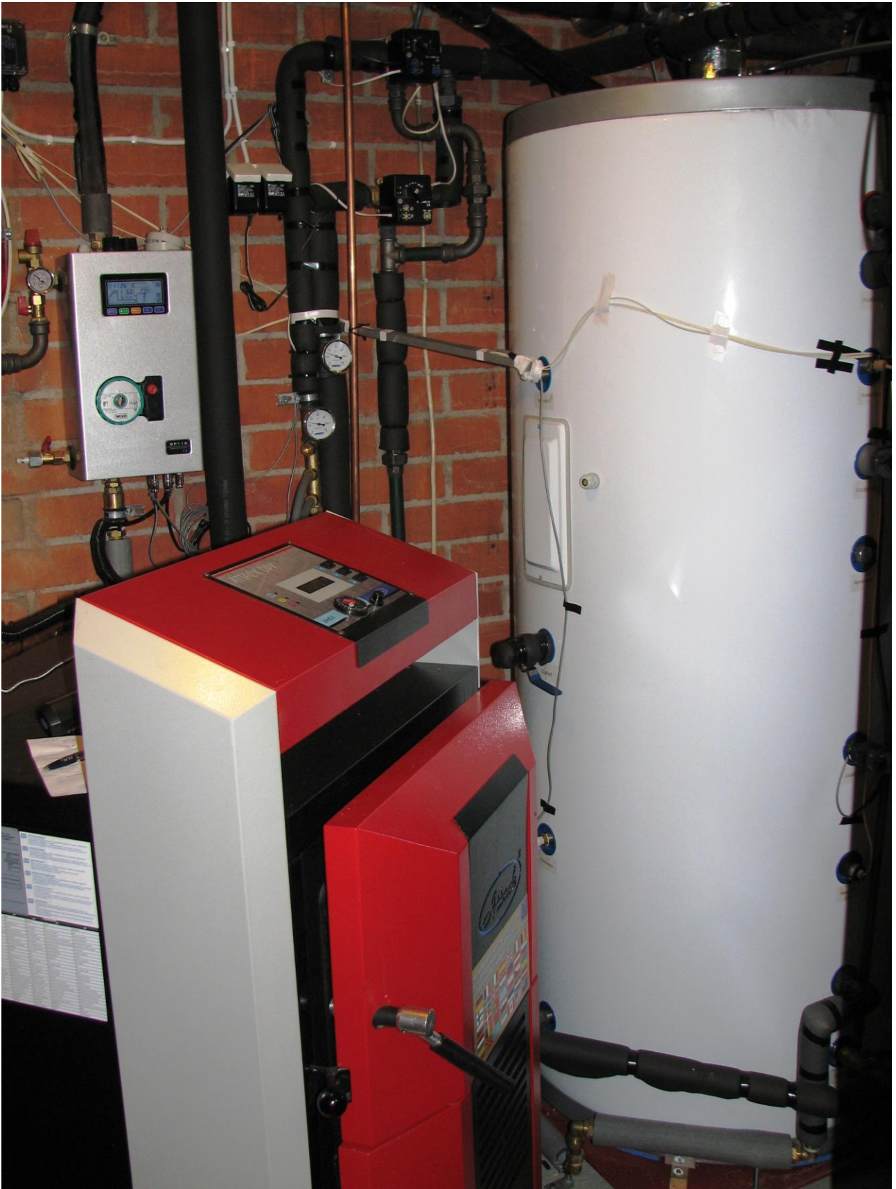
Kuva pannuhuoneesta jossa seinällä pumppuyksikkö SP-116 ja kattilan vieressä meidän EA-500L ruostumaton varaaja. Uudemmissa varaajamalleissa on säädettävät jalat + enemmän yhteitä vaihtoehtoisia energiamuotoja varten.
